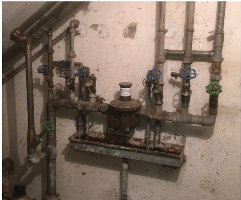
— Abb. 1.1 Erneuerung Verteilung - Vorher
