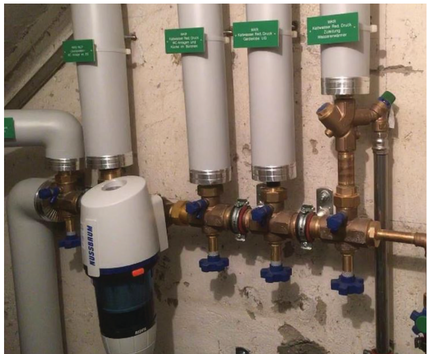
— Abb. 1.2 Erneuerung Verteilung - Nachher
